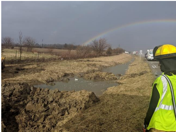
Fuel Spill over I-70
